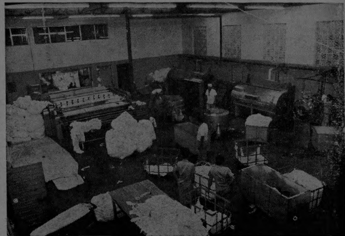
El servicio de lavandería del Hospital de Turrialba cuenta con un equipo muy moderno y de gran capacidad. Se lavan en la actualidad un total de 18.000 kilos de ropa al mes. En caso de emergencia esta lavandería puede lavar ropa de otros centros hospitalarios.
